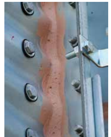
Verfüllter Spalt am Silobehälter in Oberlosa Fotos (2): Frank Hertel
