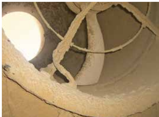
Verschmutzte Ventilatoren erhöhen den Energieverbrauch deutlich.
